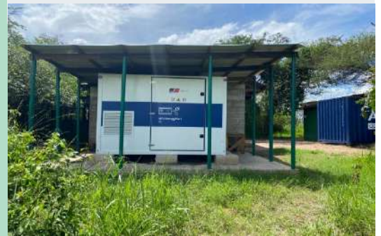
↑ 150 kVA | 267kWh Rolls Royce BESS
